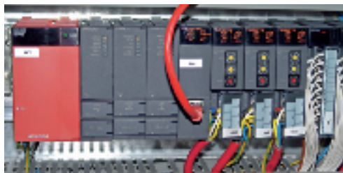
Die SPS Melsec System Q in Multiprozessorausführung steuert übergeordnet den Warenfluss beim Textildienstleister TSL.
