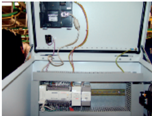
Kommandozentrale: Melsec FX (unten) und Unterseite des GOT1000-Bedienterminals (oben).
